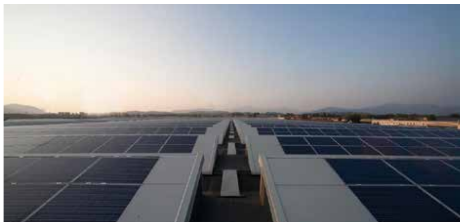
Techos fotovoltaicos de la Compañía
